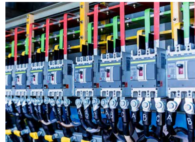
Трансформаторная подстанция Источник: Romaset / depositphotos.com
